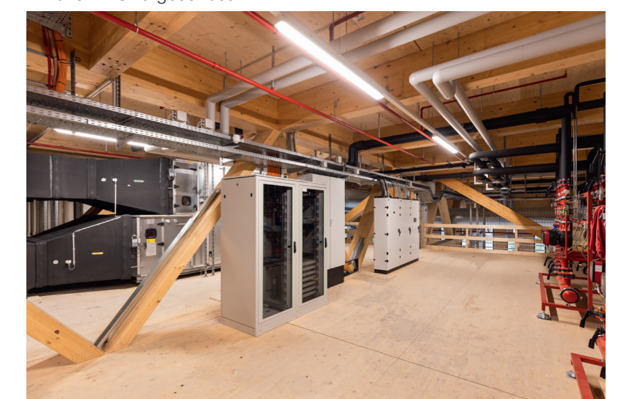
> Technikbühne im Zwischengeschoss des Produktionsbereichs
