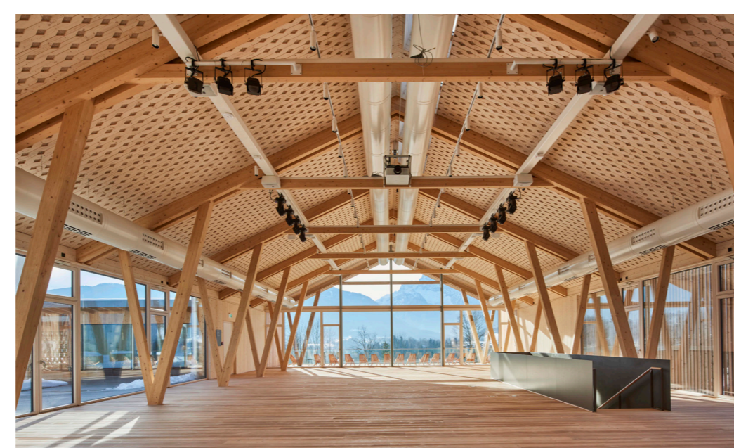
Festsaal - Neuinterpretation eines historischen Stadel-Dachstuhls mit V-Stützen, Sparrenpfetten und Ornamentdecke aus Fichte
